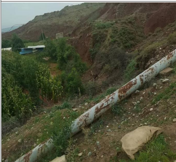
野狐沟一级泵站上水管现状
